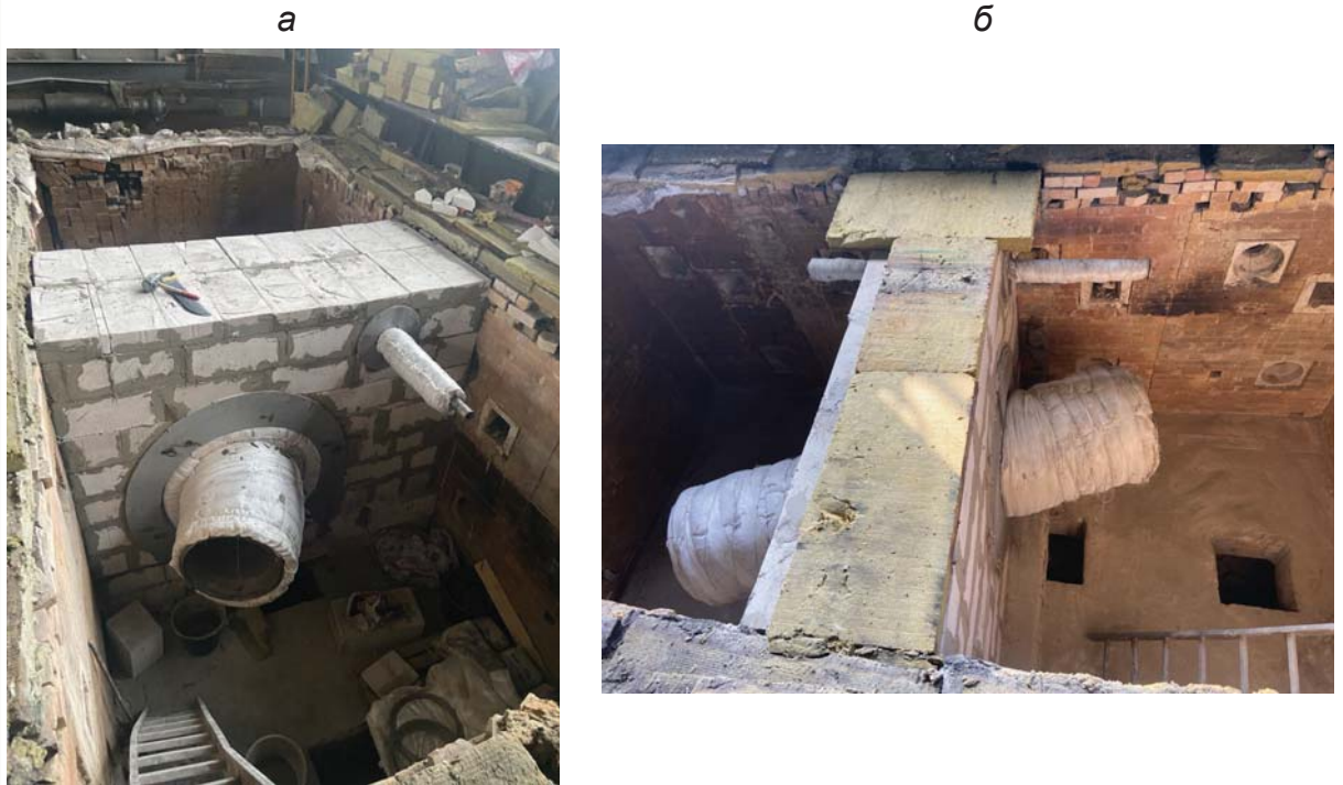
Рис. 2. Опытные образцы проходов в стене из газобетонных блоков с обогреваемой стороны: а – толщина стены 1200 мм; б – толщина стены 800 мм
