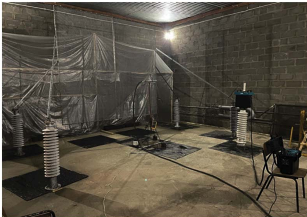
Рис. 1. Общий вид стенда по определению тока утечки из автоматических установок пожаротушения
